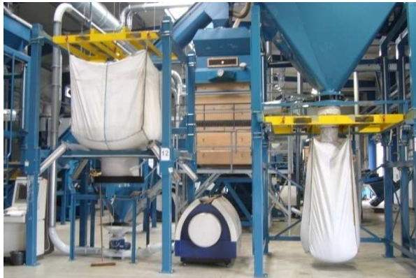
Niskociśnieniowa odpylnia o przepływie 45 tys. m powietrza/h, usuwająca strzępki tekstylne i zanieczyszczenia pyłowe z przetwarzanego surowca
